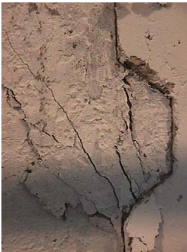
Rotura por cortante
