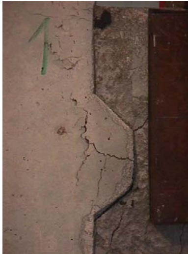
Rotura de llave a compresión
