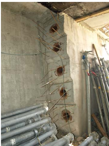
Figura 2: Traviesa de cruce de tendones de pretensado
